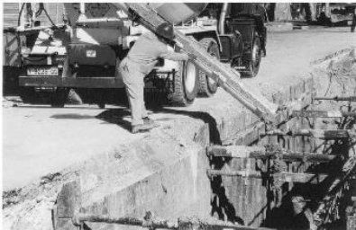
MANEJO INCORRECTO DE LA CANALETA DE VERTIDO PELIGRO DE CAÍDA A DISTINTO NIVEL
