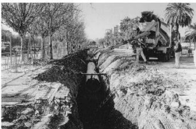
MANEJO DE LA CANALETA DE VERTIDO EN POSICIÓN FORZADA PELIGRO DE CAÍDA AL MISMO Y A DISTINTO NIVEL
