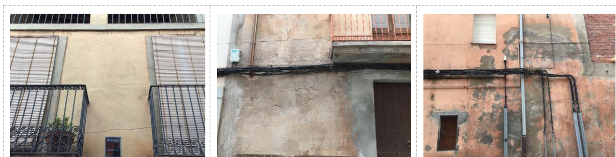
Figura 8. Exemples de fissures per envelliment.
