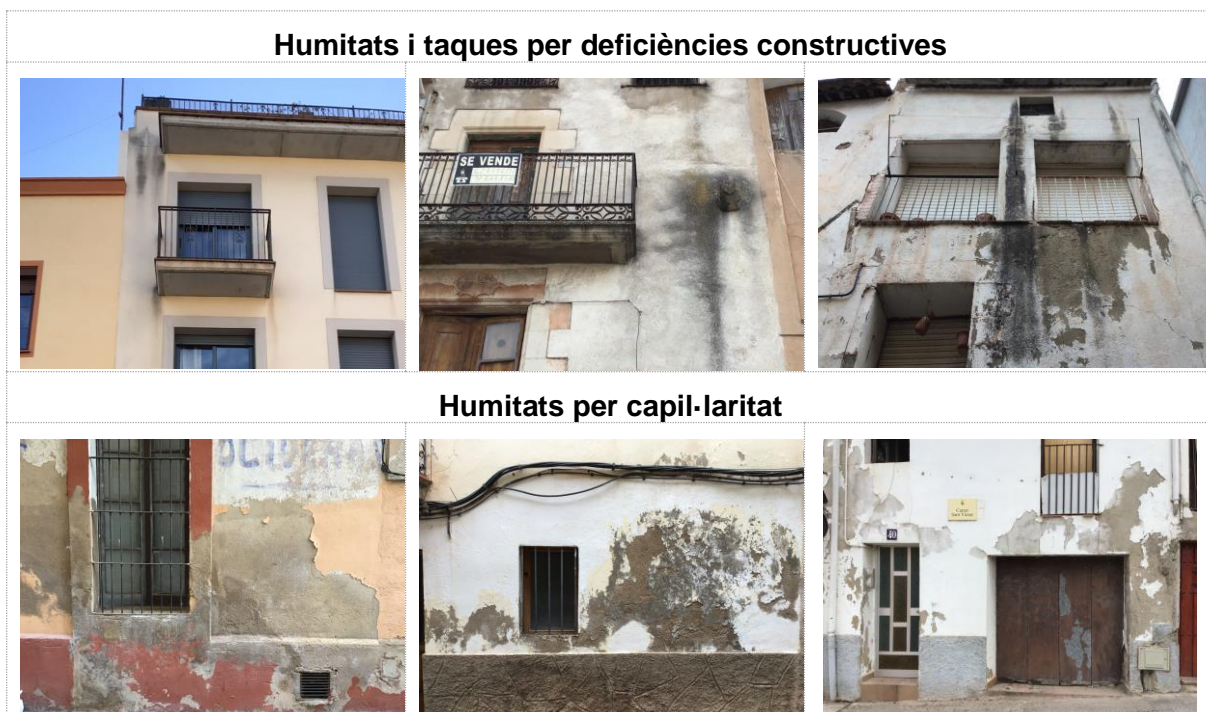
Figura 7. Exemples d'humitats i taques per deficiències constructives i per capil·laritat.
