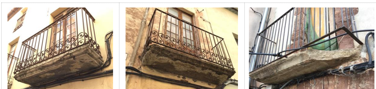
Figura 5. Exemples de balcons crítics.
