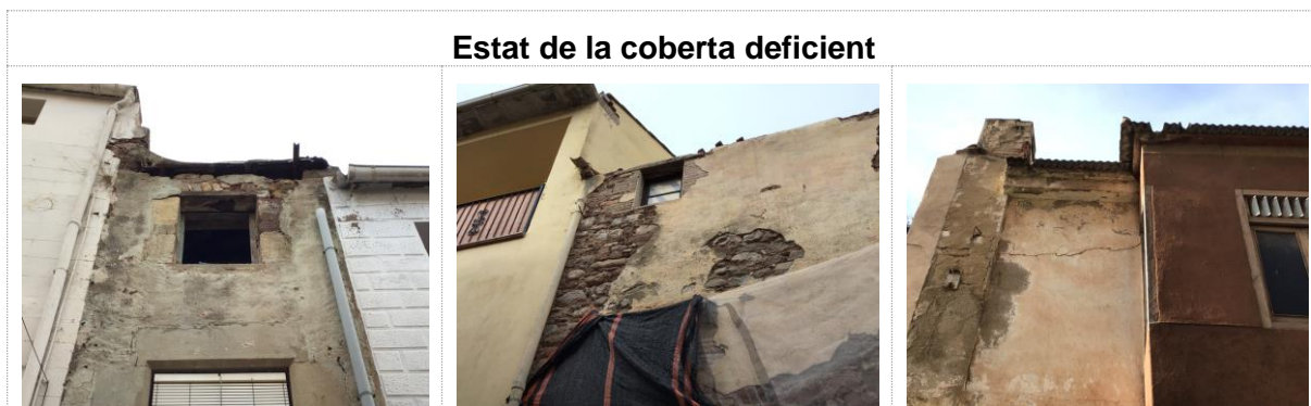
Figura 6. Exemples d'estat de la coberta deficient.
