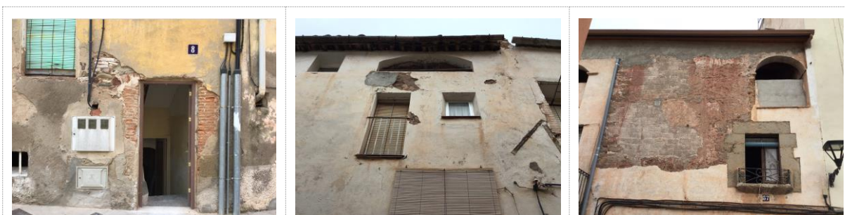
Figura 10. Exemples de despreniments de revestiment.
