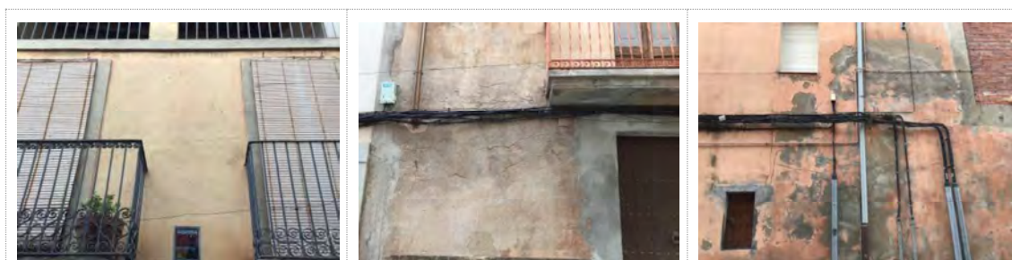
Figura 8. Exemples de fissures per envelliment.
