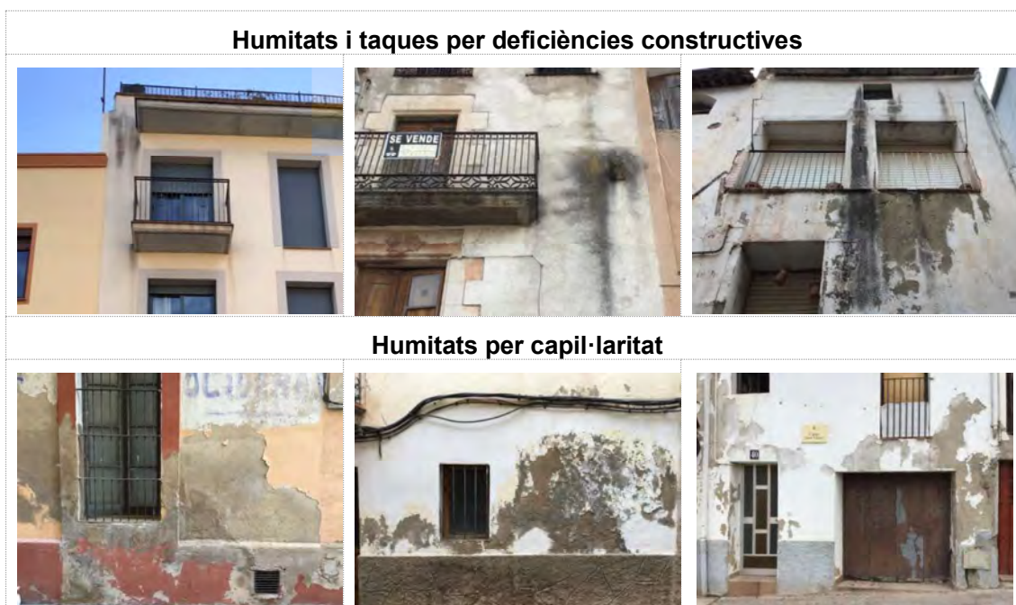
Figura 7. Exemples d'humitats i taques per deficiències constructives i per capil·laritat.
