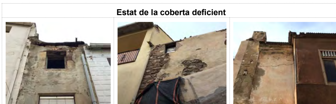
Figura 6. Exemples d'estat de la coberta deficient.
