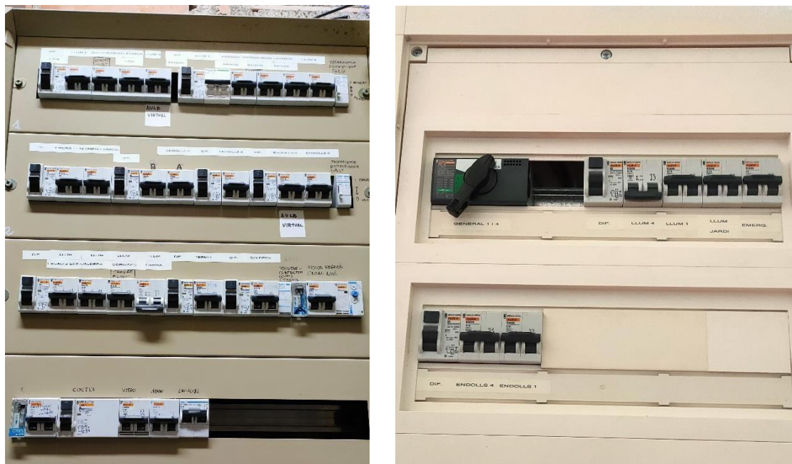
Figura 24. Quadres elèctrics sectoritzats, volum A, B i C. Elaboració pròpia.
