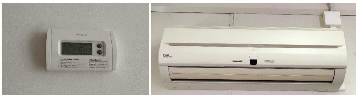
Figura 42. Sistema de climatització centralitzat de calefacció a l'edifici principal i annexos, i sistema de bomba de calor a mòduls complementaris (menjador). Elaboració pròpia.
