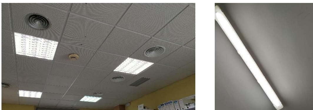
Figura 15. Tipus de lluminàries fluorescents a les sales de l'edifici. Elaboració pròpia.
