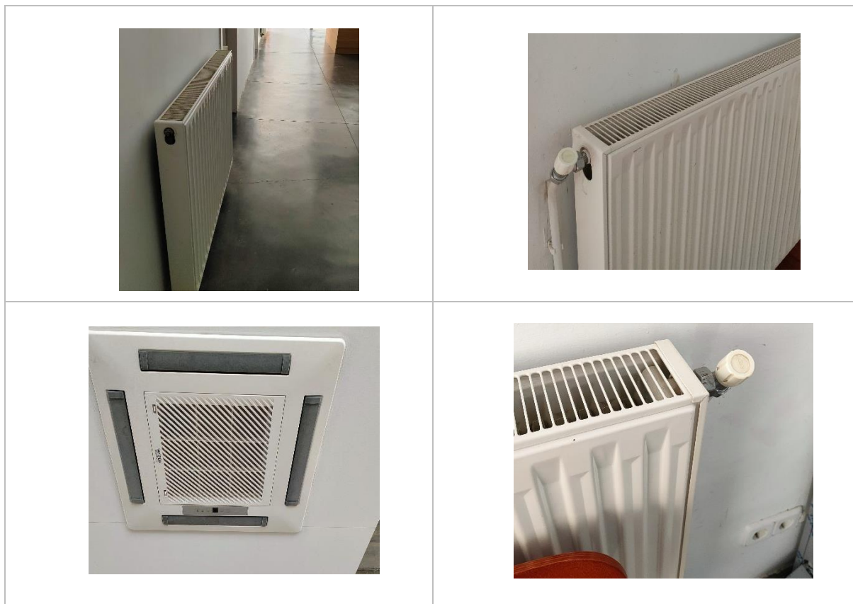
Figura 23. Sistemes de climatització (radiadors i bomba de calor tipus "Split"). Elaboració pròpia.
