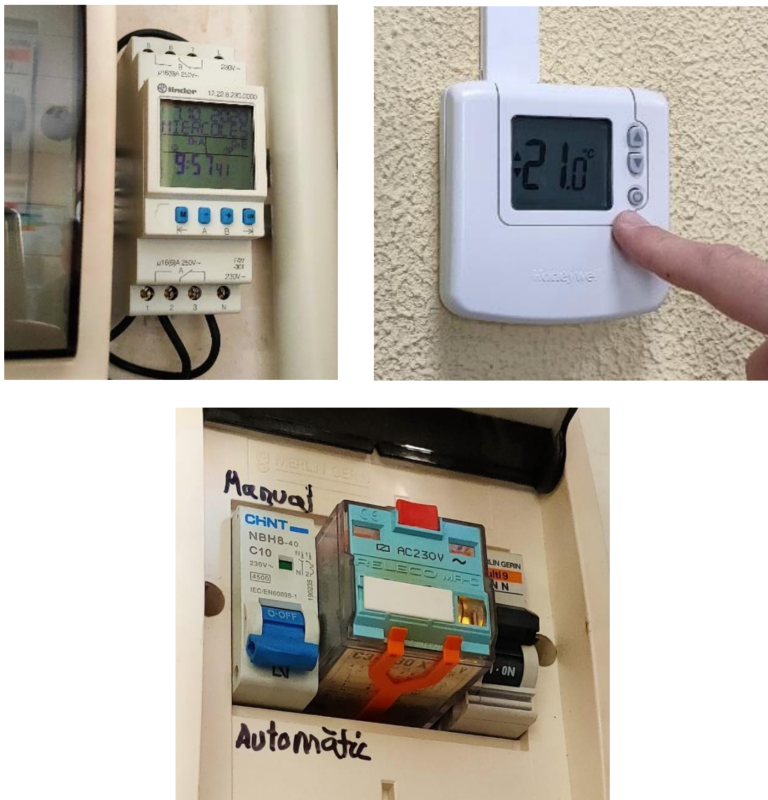
Figura 5. Programador del sistema de calefacció i termòstat instal·lat a les sales, i aparell que identifica si el sistema de climatització està programat automàtic o s'ha d'engegar manualment. Elaboració pròpia.
