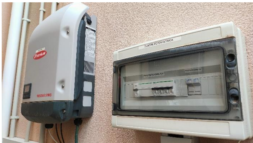
Figura 14. Inversor trifàsic de 3 kw. Elaboració pròpia.
