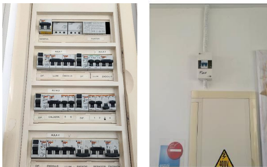
Figura 37. Quadre elèctric i programador del sistema de calefacció. Elaboració pròpia.
