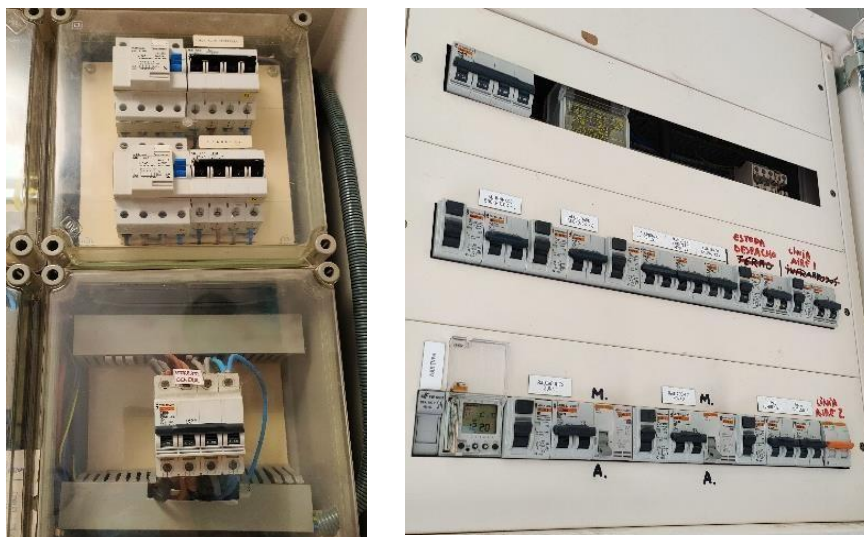
Figura 43. Quadre elèctric. Elaboració pròpia.
