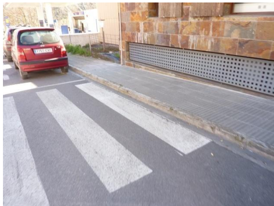
Imatge 104. Manca d'accessibilitat també al costat est.
