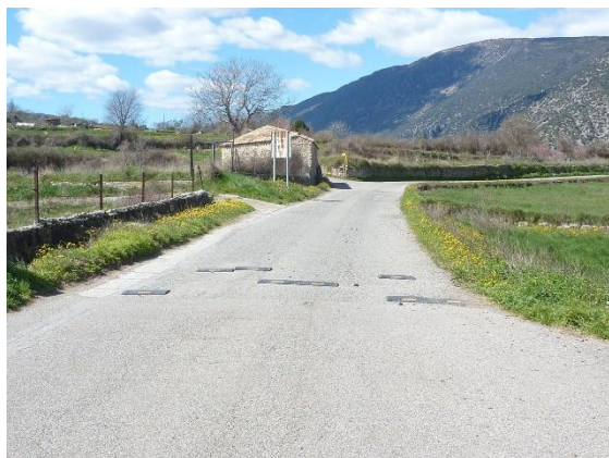
Imatge 35. Bandes trencades a l'av. de Santa Fe.
