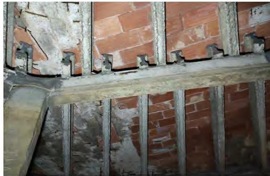
9. Escrostonamen i corrosió en jàssera P1-P2
