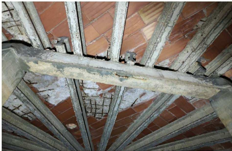
8. Escrostonamen i corrosió en jàssera P8-P1
