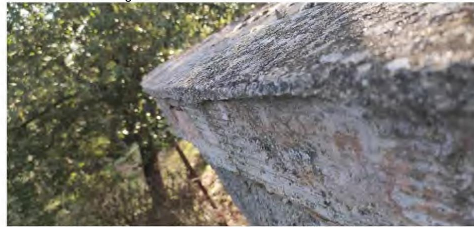
11. Vora de coberta disgregada
