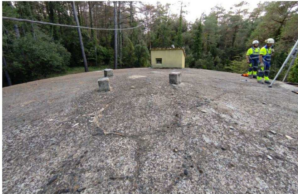
11. Fissures en coberta
