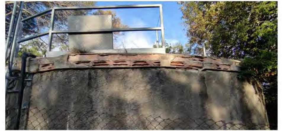
9. Vora de coberta disgregada
