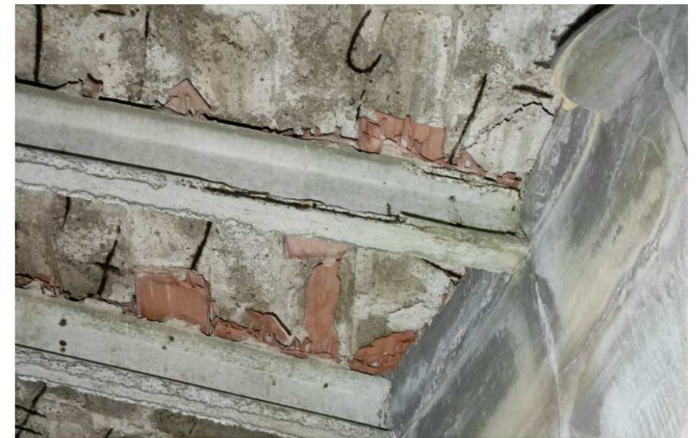
10. Escrostonamen i corrosió en bigueta 44
