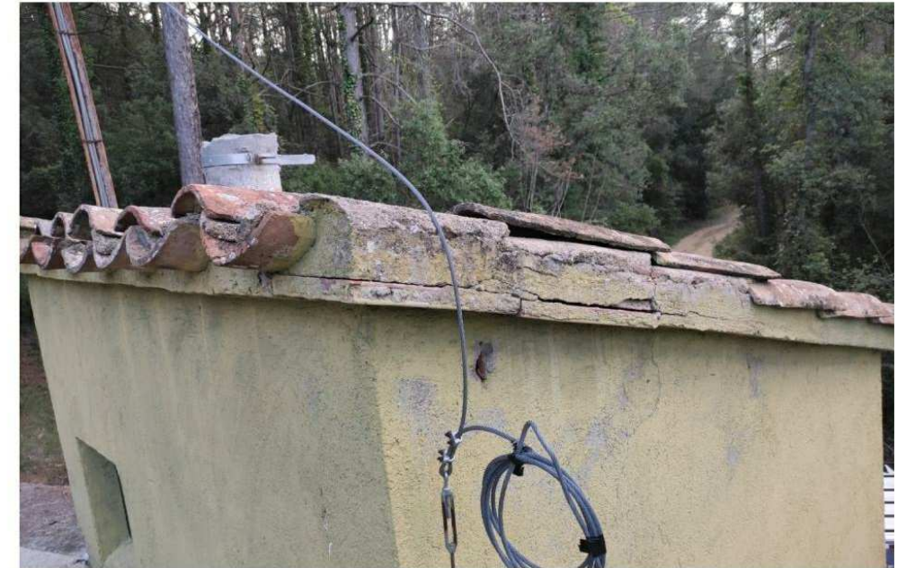
16. Coberta sala de instal·lacions en mal esta de conservació
