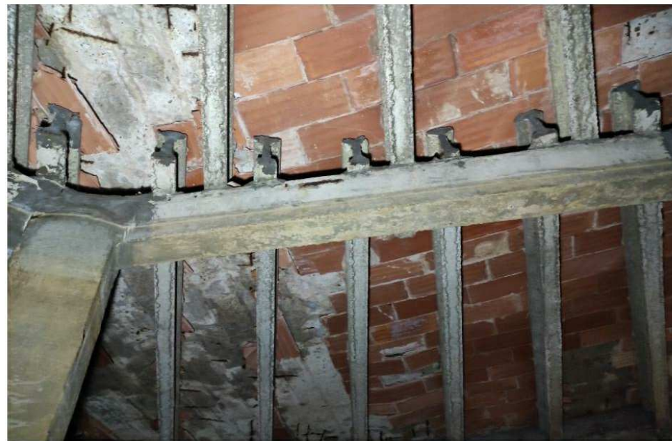
9. Escrostonamen i corrosió en jàssera P1-P2
