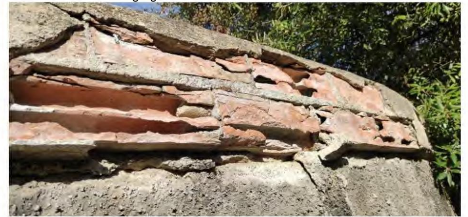
12. Vora de coberta disgregada
