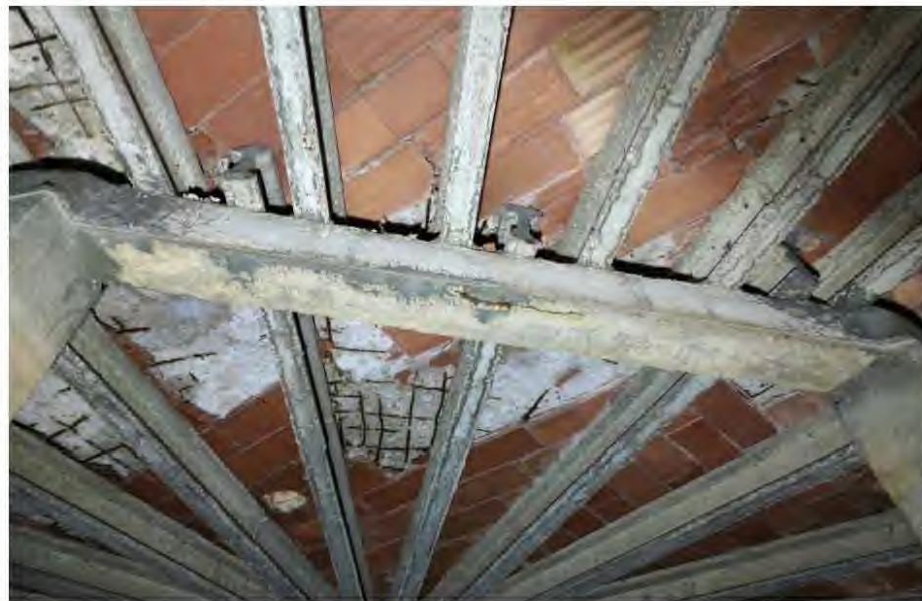
8. Escrostonamen i corrosió en jàssera P8-P1
