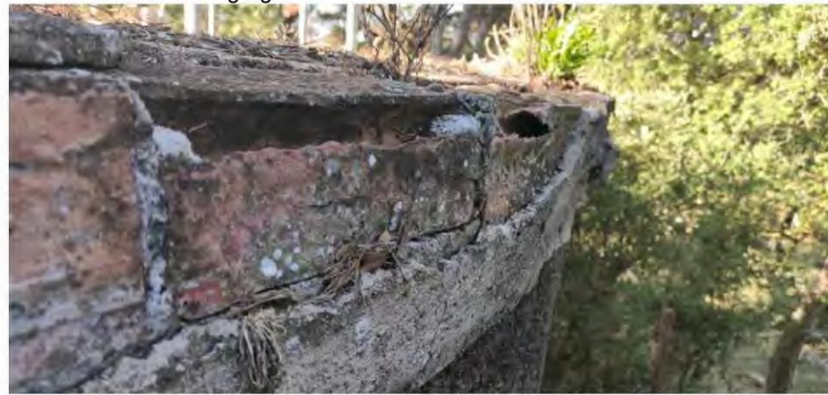
10. Vora de coberta disgregada
