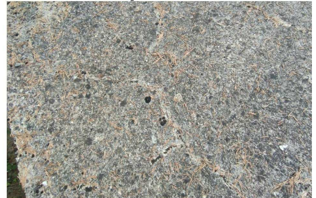
13. Fissures en coberta
