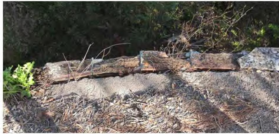
7. Vora de coberta disgregada
