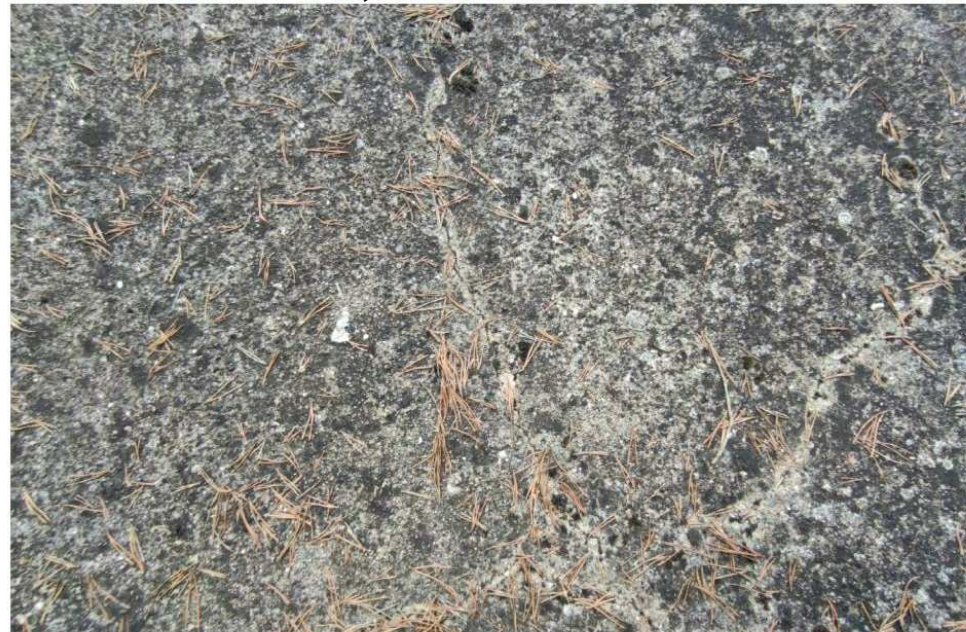
12. Fissures en coberta
