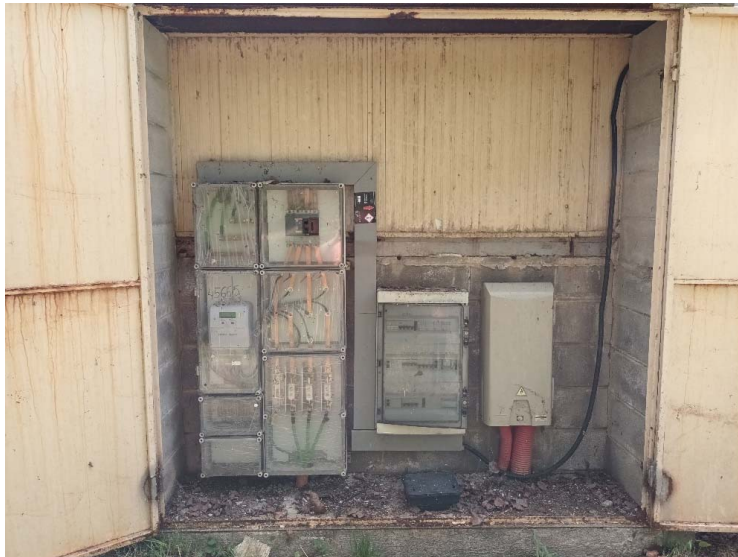
Fotografia num 1: Detall CGP - comptador – quadre de maniobra i comandament
