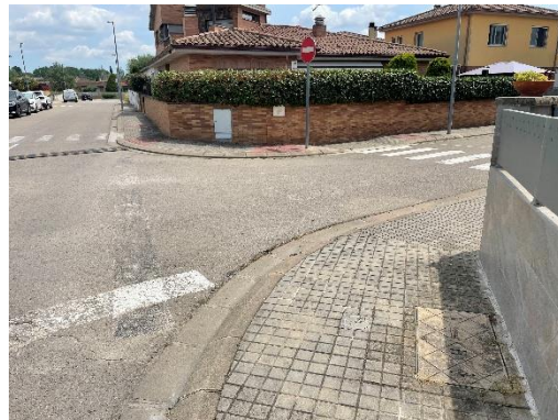
Imatge 37. Cruïlla amb passos de vianants no alineats amb l'itinerari del vianant
