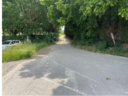
Imatge 7. Senyalització horitzontal sense manteniment a l'escola Frigolet.
