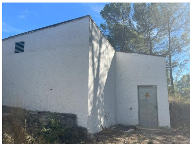
Fotografia 9. Dipòsit en servei
