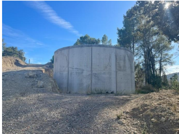
Fotografia 7. Dipòsit nou de Puig Surís (no en ús)
