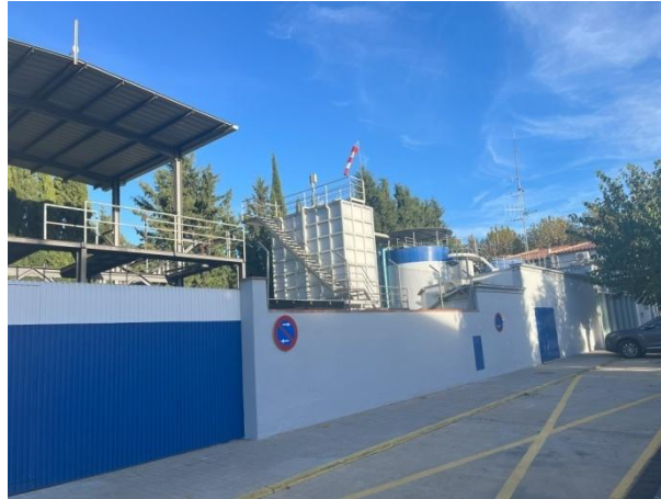
Fotografia 3. Vista general de la instal·lació
