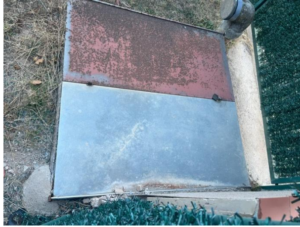
Fotografia 5. Registres i ventilacions
