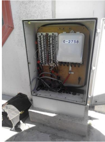
Il·lustració 22. Caixa terminal òptica (CTO) instal·lada en Pedestal.
