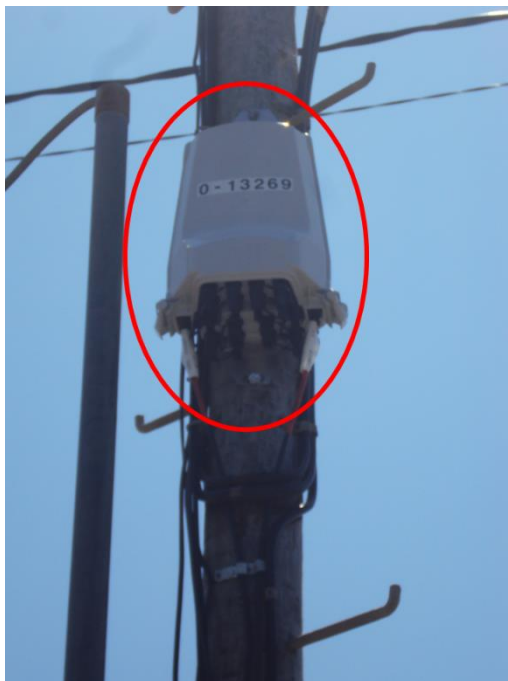
Il·lustració 21. Caixa terminal òptica (CTO) instal·lada en pal.
