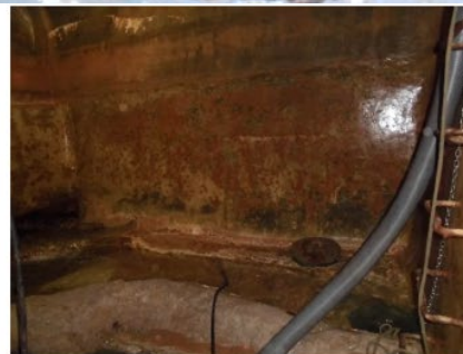
Foto 7. Interior de la captació.
