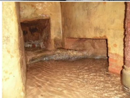
Foto 6. Interior de la captació.
