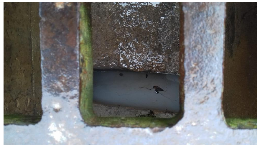
Foto 21. Esquerda detectada a la canonada que recull l'aigua del primer embornal on previsiblement va arribar el gasoil de la fuga.
