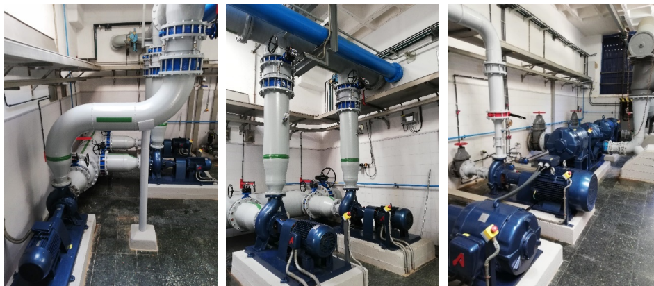
Bufador, compressors d'aire comprimit i calderí
