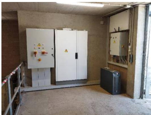
15. CGBT a l'interior de l'estació de bombament
