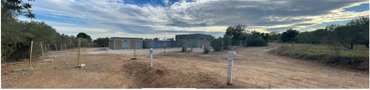
Vista del dipòsit i de les instal·lacions annexes, i del pas de la canonada del CAT
