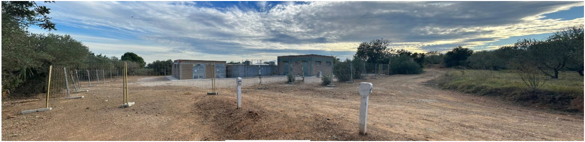
Vista del dipòsit i de les instal·lacions annexes, i del pas de la canonada del CAT
