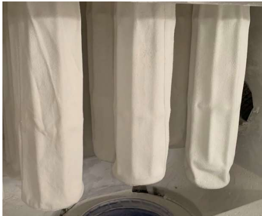
Imagen 20 Detalle de las mangas del filtro.
