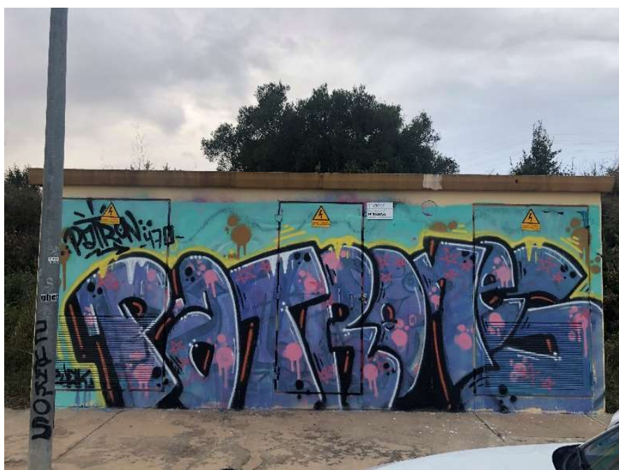
Imagen 39 Centro de transformación actual de ENDESA 104694
