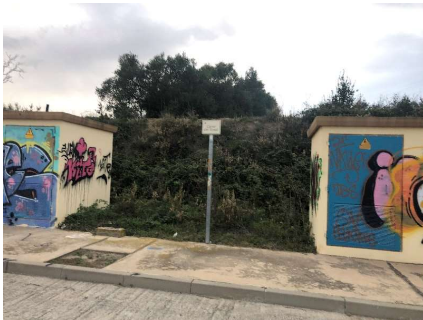
Imagen 41 Frontal de ambos centros de transformación.
