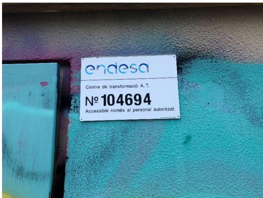
Imagen 38 Centro de transformación actual de ENDESA 104694
