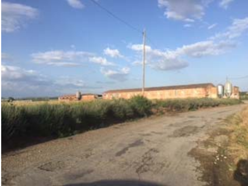
Imatge del camí degradat, quartejat ple de sots amb un paviment de DTS.
