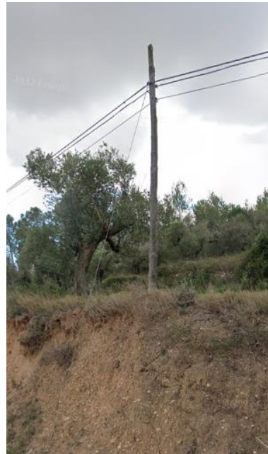
A.3.6. Suport 6: P-78, coordenades X: 339.914 - Y: 4.560.813. Desmuntar riosta ST-2.5 1500 i instal·lar riosta ST-3.0-2000.
