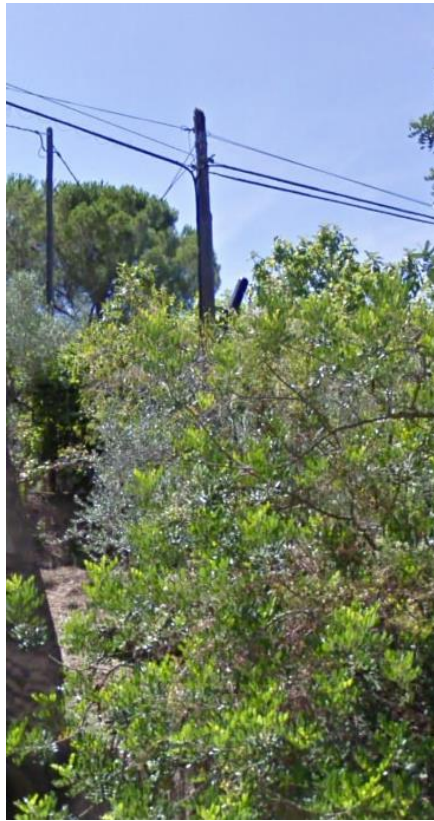
A.3.3. Suport 3: P-61, coordenades X: 340.038 - Y: 4.560.699. Substituir suport de fusta 8 E a fusta 8 D.
