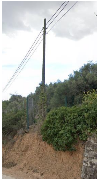
A.3.5. Suport 5: P-76, coordenades X: 339.993 - Y: 4.560.736. Substituir suport de fusta 8 E a fusta 8 D.
