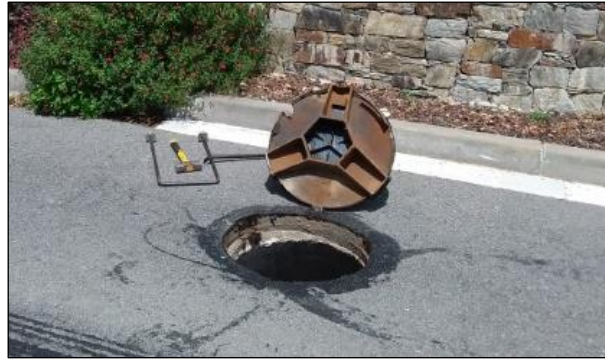
Figura 24: Exemple de tapa trencada (p072)
