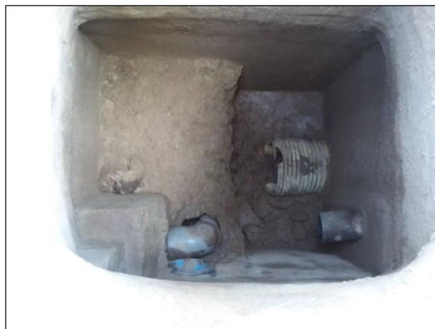
Figura 19: Sobreeixidor en el pou p026
