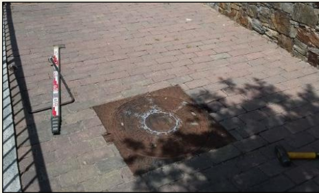
Tapa en mal estat
