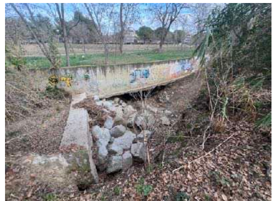
Fot. 10. Detall del descalç d'un mur d'endegament en una zona de gual
