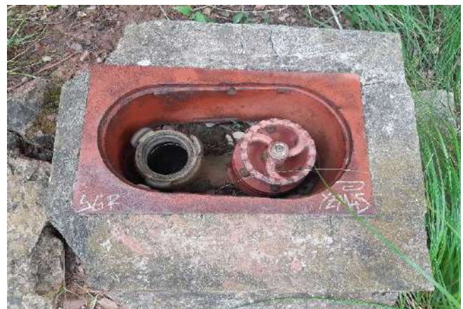
Hidrant existent a peu de camí
