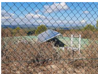
Dipòsit actual amb plaques solars
