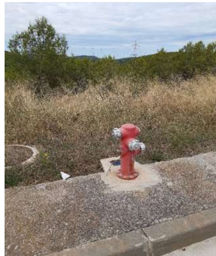
Hidrant existent urb Can Mitjans
