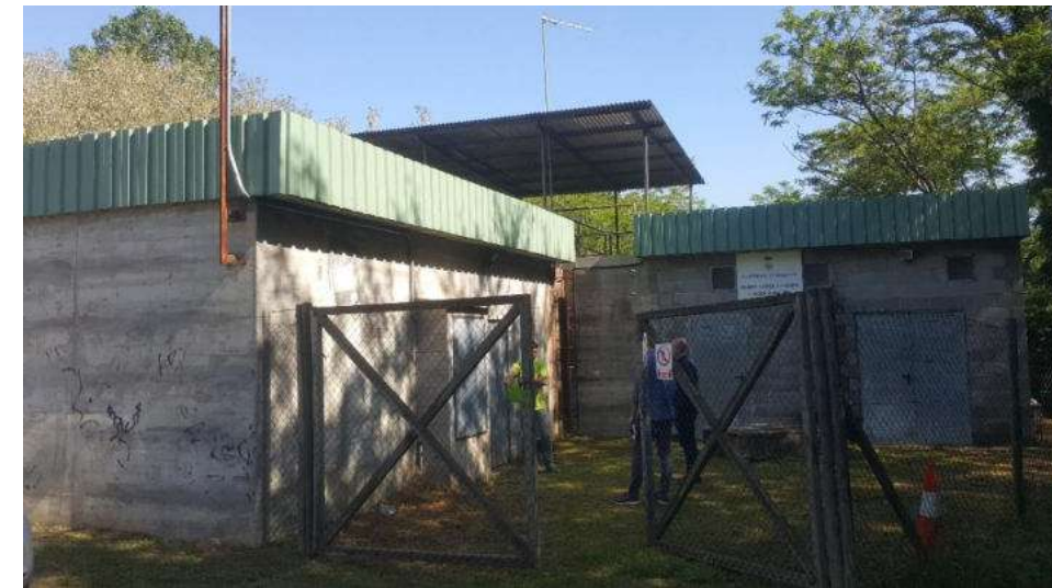
Figura 14 - Exterior Dipòsit ETAP.
