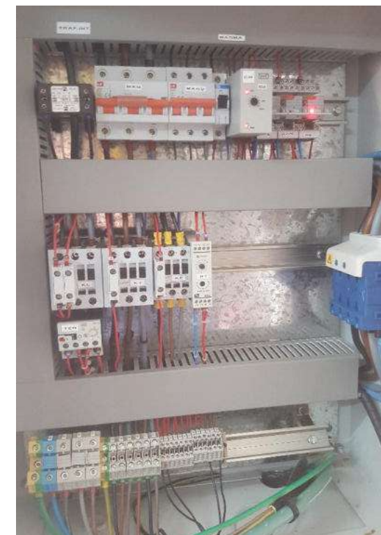
Figura 23 - Quadre elèctric ETAP.
