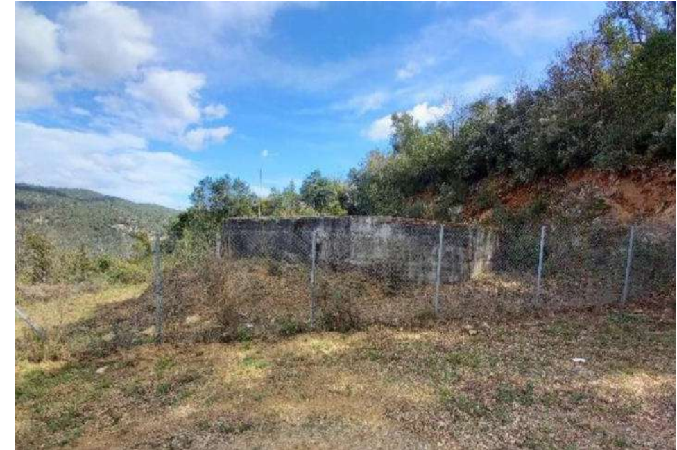
Figura 7 - Exterior Dipòsit Riu Clar.
