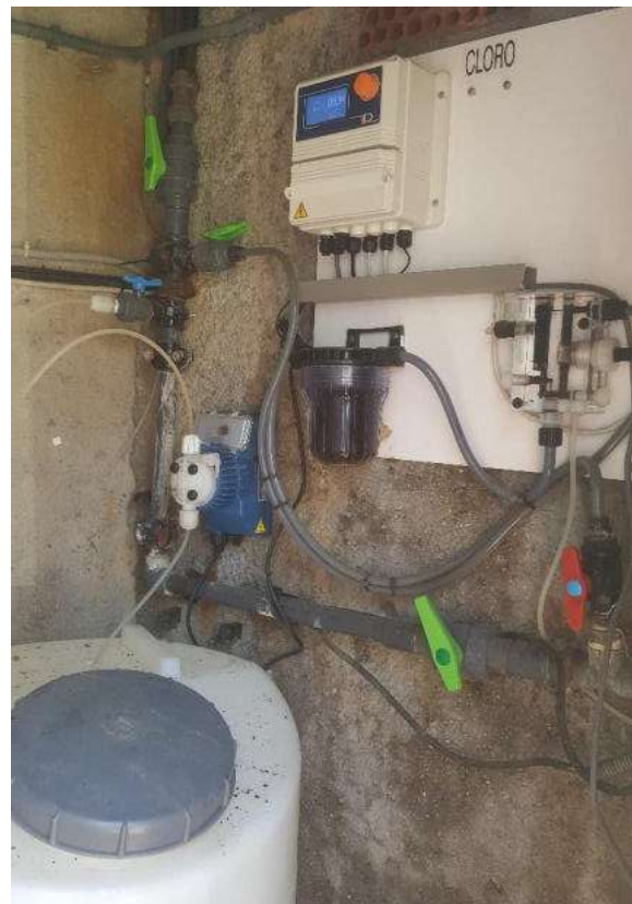
Figura 26 - Sistema de cloració dipòsit Can Regàs.
