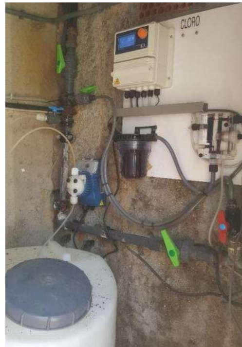
Figura 6 - Sistema de cloració dipòsit Can Regàs.
