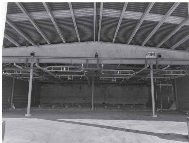
Foto 2: Interior del almacén de biomasa
