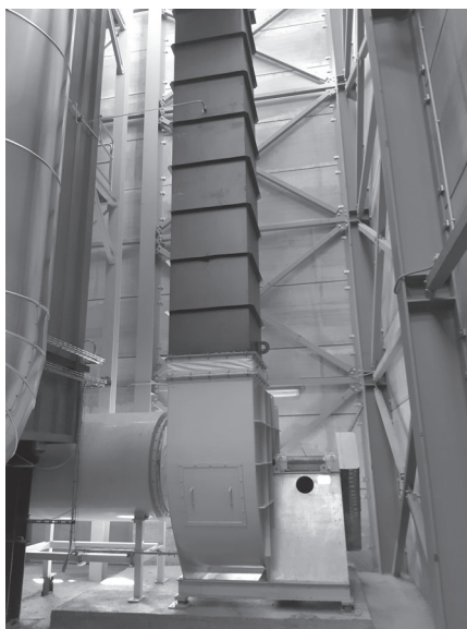
Fig.7 Ventilador de Aire Forzado (FDF) Primario
