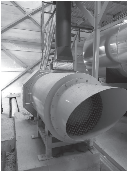
Fig.8 Ventilador de Aire Forzado (FDF) Secundario
