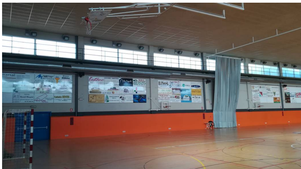
Imatge 3. Sistema de ventilació.
