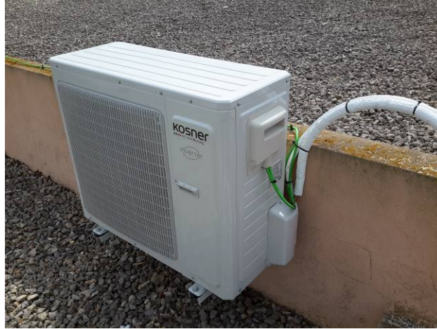
Imatge 4. Unitat exterior condensadora dels equips de climatització.
