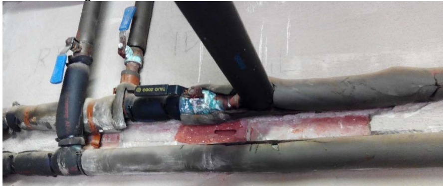
Imatge 5. Canonades de subministrament de calefacció.
