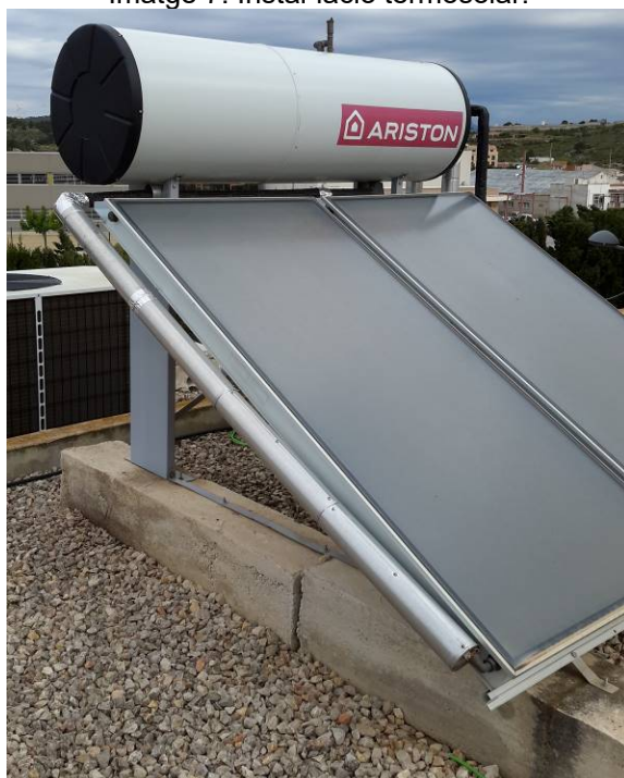
Imatge 7. Instal·lació termosolar.
