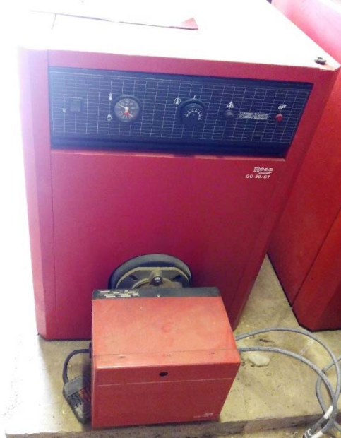
Imatge 3. Caldera de Gasoil C.
