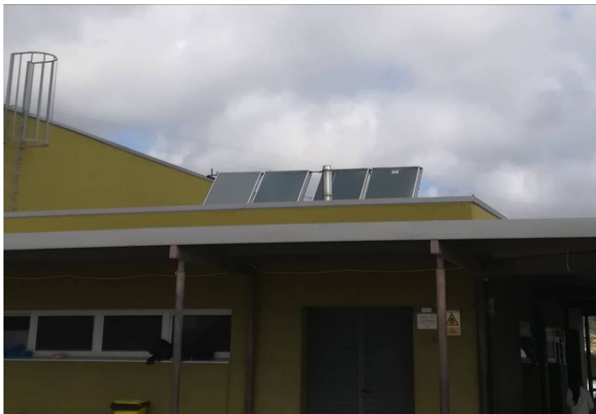
Imatge 7. Panells termosolars.
