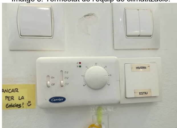
Imatge 3. Termòstat de l'equip de climatització.
