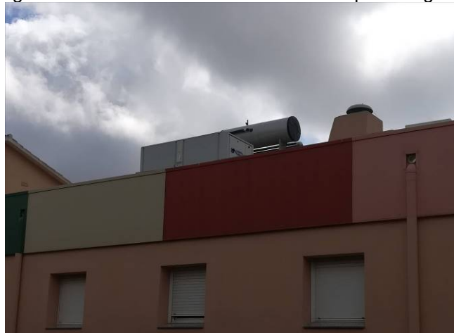
Imatge 6. Unitat exterior condensadora dels splits del gimnàs.
