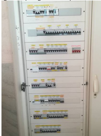
Imatge 6. Tipologia de comptador i QGBT.
