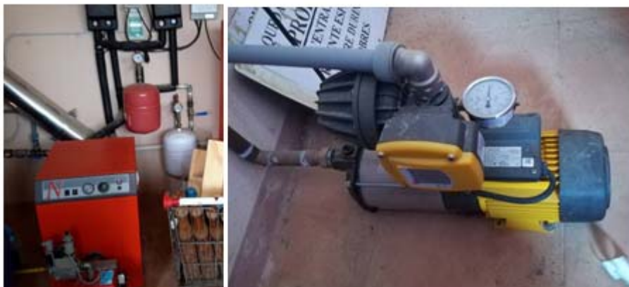
Imatge 4. Caldera per ACS i bomba de pressió.
