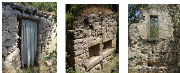
Vista dels coberts aïllats, que es troben en ruïnes. Es veuen les llindes, els ampits i els brancals de pedra.
