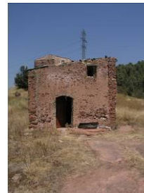
Vista sud del cobert no adossat de pedra i coberta en mal estat
