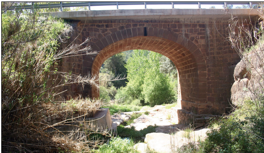
Fig.16. Pont de la carretera B-122 sobre la riera de Rellinars (Punt R2).
