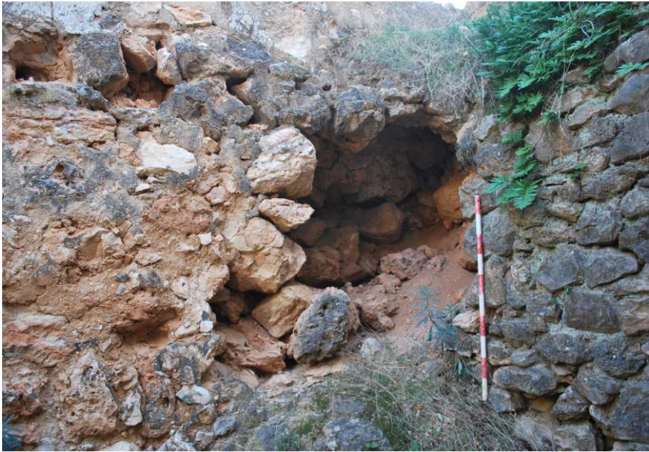
Gran esvoranc sota la cantonada entre els murs M7 i M11 del Cos oest (J. Gibert).
