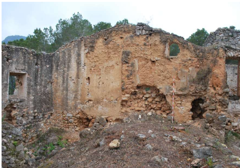
Vista des del sud del mur M9, on s'observen els grans esvorancs que presenta a la base i, a la part central, l'arrencament del mur M11; a la dreta es poden reconèixer el paviment i els arrebossats del pis (J. Gibert).
