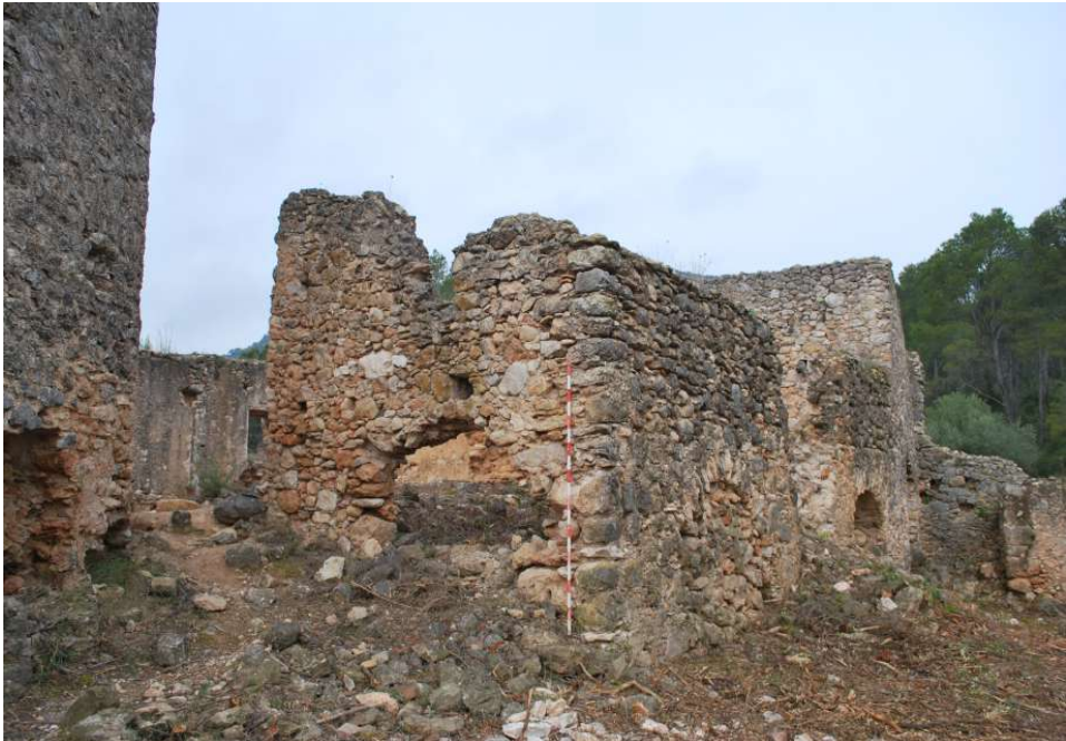
Vista des de l'exterior de l'àmbit 3, a tocar de la torre; s'observa el gran esvoranc a la seva base (J. Gibert).
