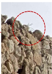
Presència de vegetació en la secció ensulsiada. Font: Arquitectes.cat, Abril 2021
