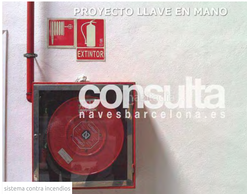
sistema contra incendios
