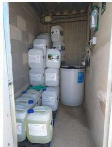
Emmagatzematge i cloració
