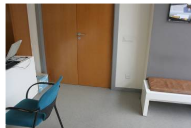
Portes d'accés a la Sala de Plens de l'Ajuntament (fulles inferiors a 0,80m)
