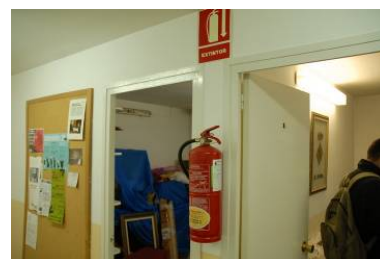
Extintor a recorregut de pas al Casal de la Dona
