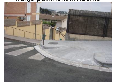
Franja paviment diferenciat mal disposada per al creuament
