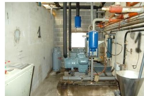
INSTAL·LACIONS A L'ALTELL TÈCNIC
