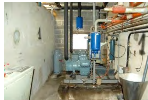
INSTAL·LACIONS A L'ALTELL TÈCNIC
