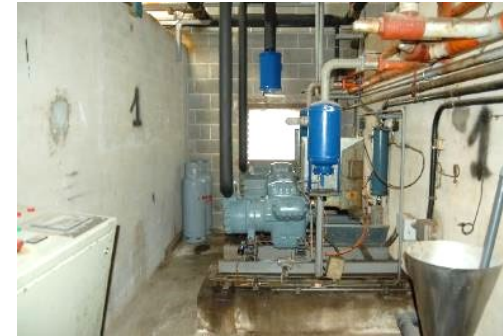
INSTAL·LACIONS A L'ALTELL TÈCNIC
