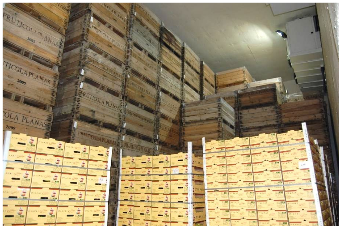
INTERIOR D'UNA CAMBRA FRIGORÍFICA
