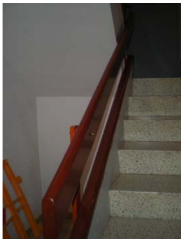
Mostra de passamans d'alçada insuficient.
