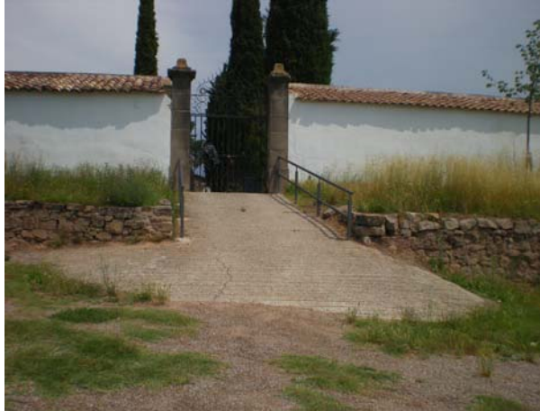
Accés amb rampa de pendent superior a la permesa.
