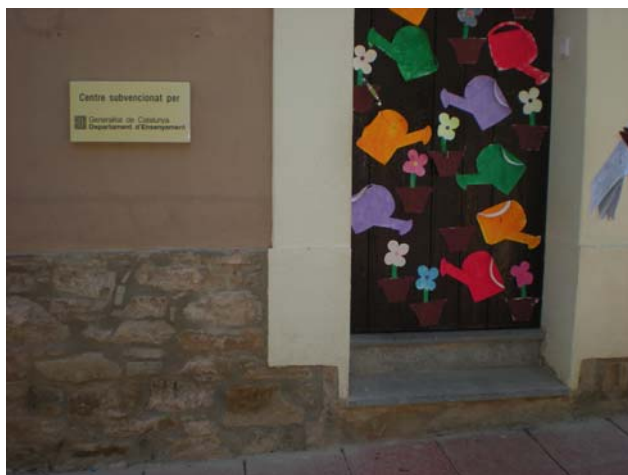
Exemple de rètol d'identificació d'un edifici, poc llegible
