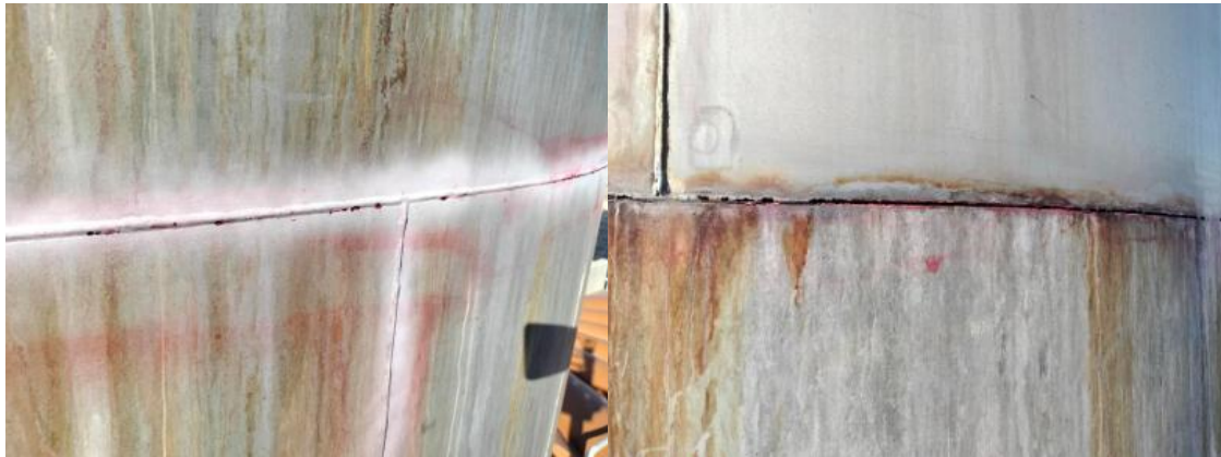
Figura 3. Estat de la soldadura 1 de la sitja.
