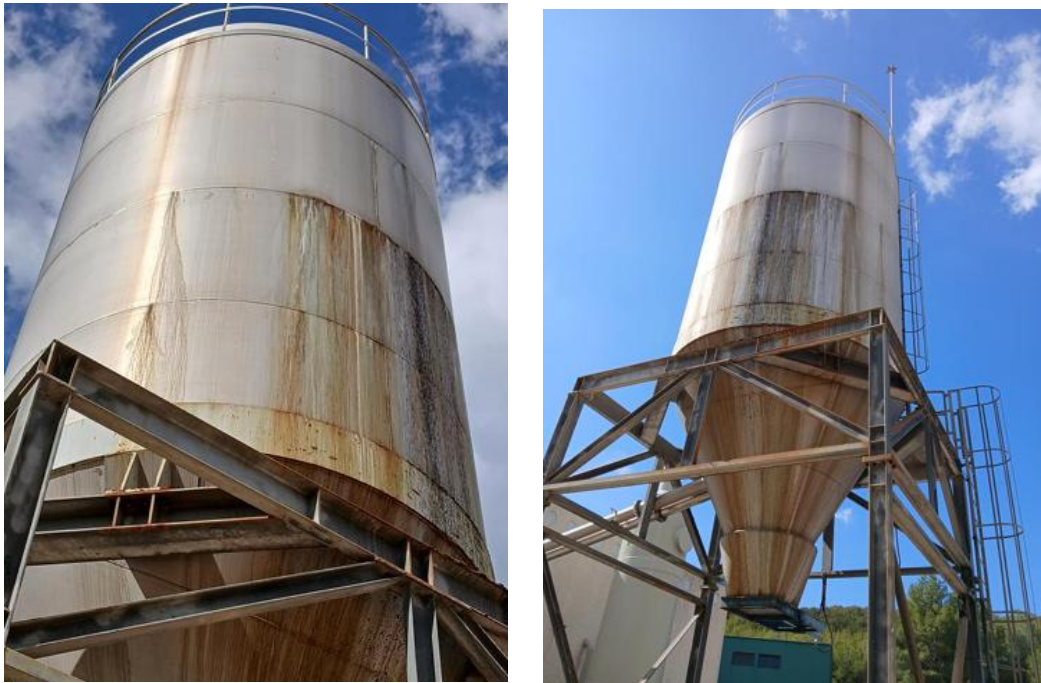
Figura 1. Imatges de l'estat de les viroles afectades de la sitja.
