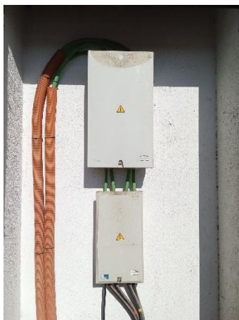
Figura 15. Punt de connexió existent al Local Social de Medinyà. Font: elaboració pròpia.
