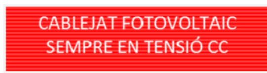
Figura 14. Senyalització cablejat CC. Font: Bombers de Barcelona.
