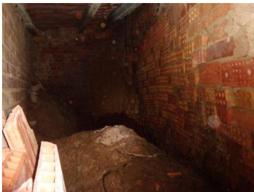
Fotografia 10. Arqueta de registre
