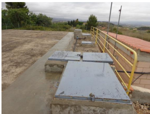
Fotografia 35. Arquetes registre Dipòsit La Cometa
