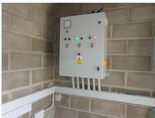
Fotografia 65. Quadre elèctric Dipòsit Les Masies
