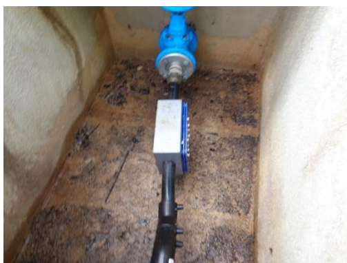
Fotografia 15. Arqueta i dscalcificador
