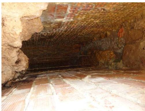
Fotografia 9. Arqueta de registre
