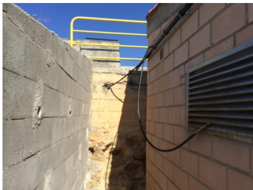
Fotografia 37. Ventilacions i reixes Dipòsit La Cometa
