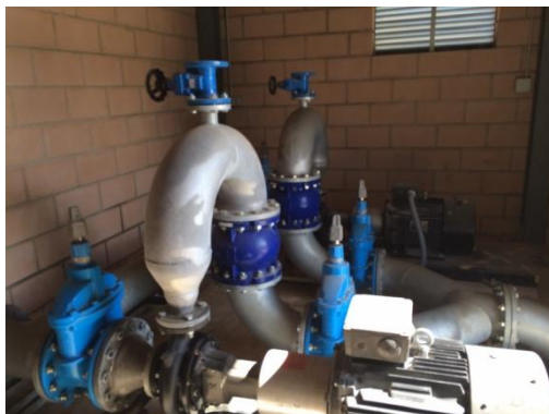
Fotografia 40. Bombes impulsió Dipòsit La Cometa a St. Miquel
