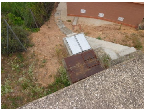
Fotografia 63. Arqueta sortida Dipòsit Les Masies
