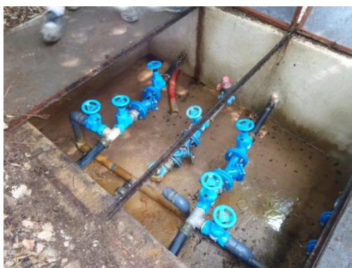
Fotografia 5. Arqueta valvuleria de derivació
