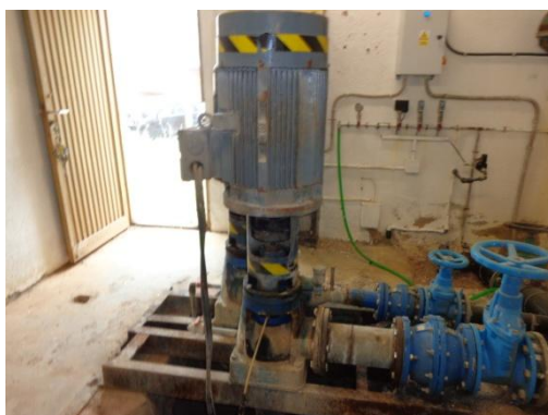
Fotografia 19. Bombes impulsió pou Biela
