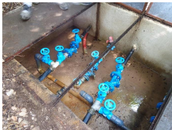
Conduccions a l'interior de l'arqueta
