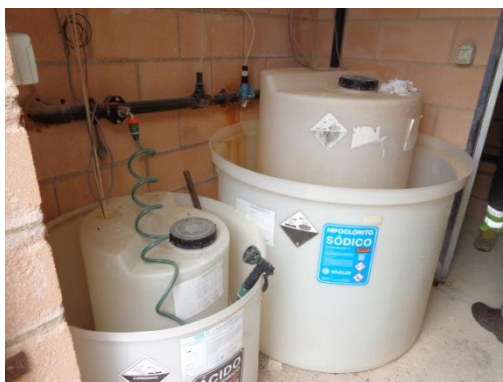
Fotografia 41. Emmagatzematge de clor i cubeta seguretat Dipòsit La Cometa
