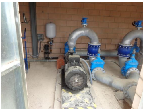
Fotografia 38. Bombes impulsió Dipòsit La Cometa a St. Miquel
