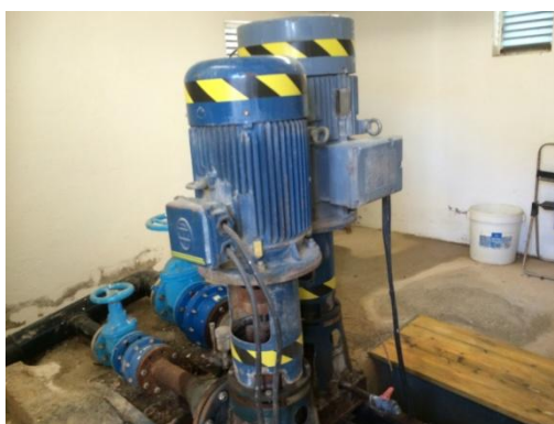
Fotografia 20. Bombes impulsió pou Biela
