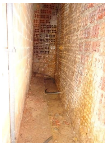
Interior i recollida d'aigua dels brolladors a les parets
