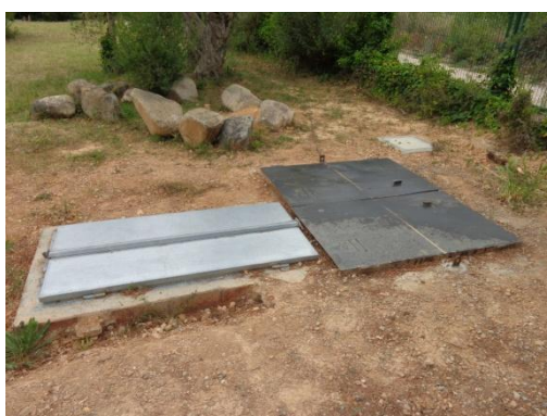
Fotografia 24. Emplaçament i arquetes pou Garber
