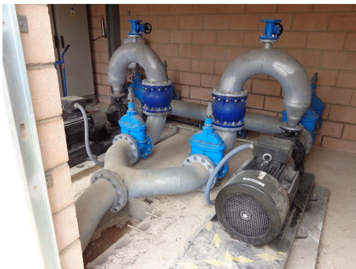
Grup de pressió Impulsió a dipòsit de La Cometa
