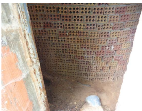
Fotografia 11. Fons filtrant registre
