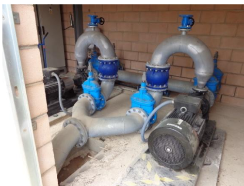
Fotografia 39. Bombes impulsió Dipòsit La Cometa a St. Miquel
