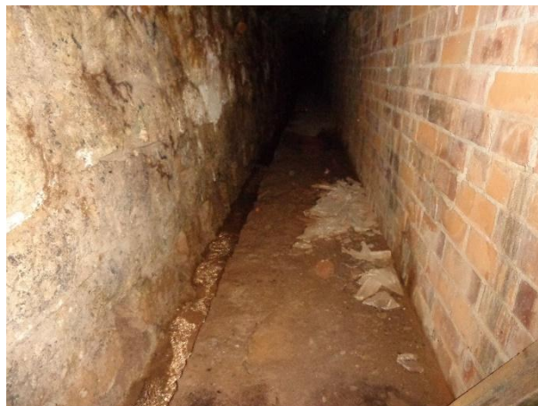
Interior i recollida d'aigua dels brolladors a les parets
