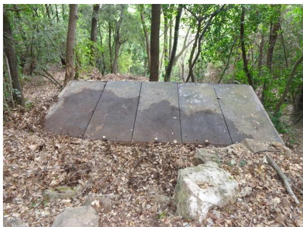
Exterior arqueta de formigó
