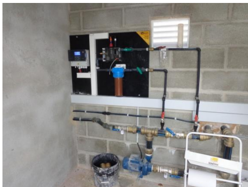
Fotografia 64. Equip cloració automàtica Dipòsit Les Masies
