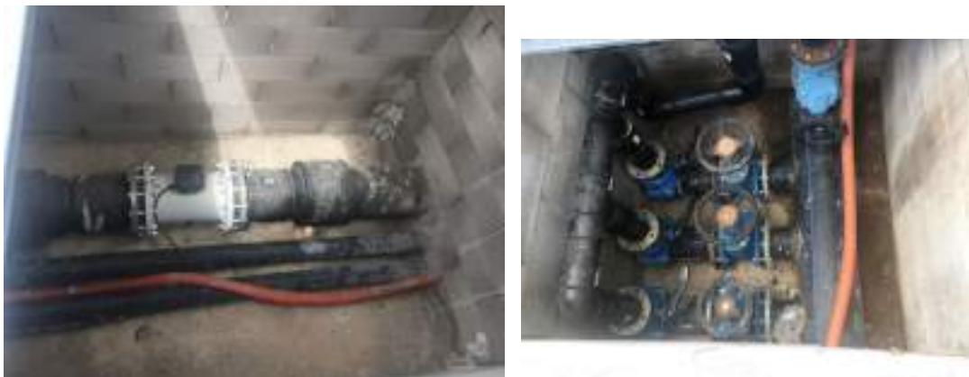
Figura 11 Cabalímetre a la sortida de dipòsit i ramals de distribució al municipi (font: pròpia)
