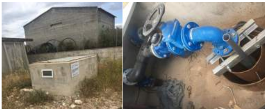
Figura 7 Captació subterrània del Pou Nou. (font: pròpia)
