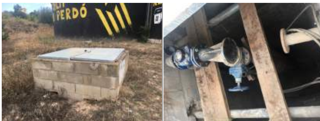
Figura 8 Captació subterrània del Pou Vell (font: pròpia)
