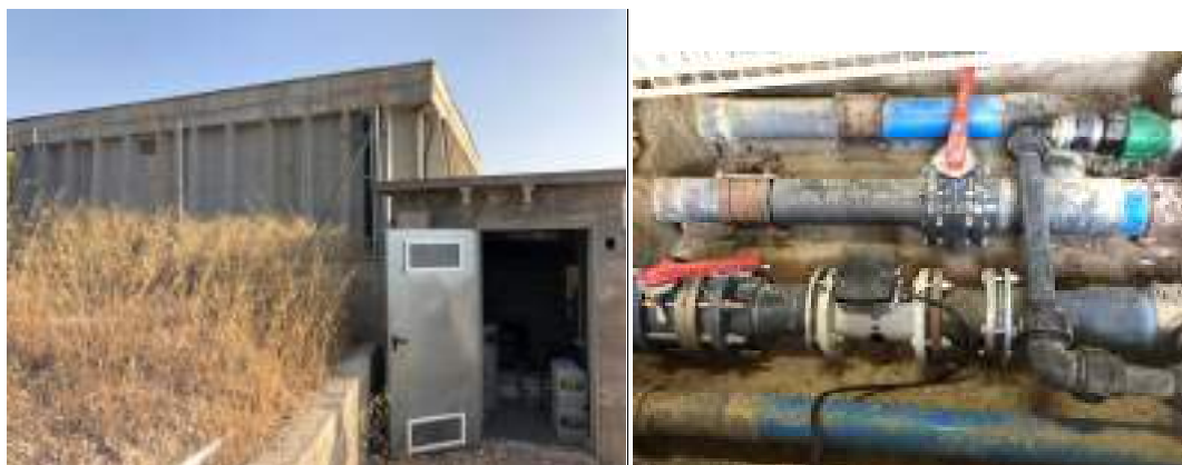
Figura 9 Dipòsit gran de Benissanet. Canones d'entrada i sortida (font: pròpia)
