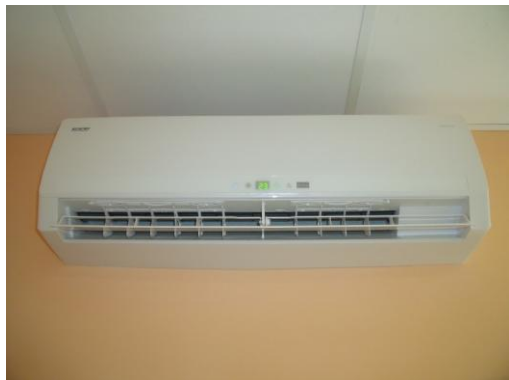
Figura 5. Unitat interior de climatització climatització
