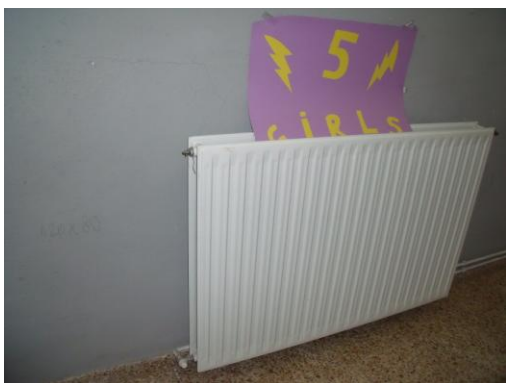
Figura 3. Unitats terminals de climatització
