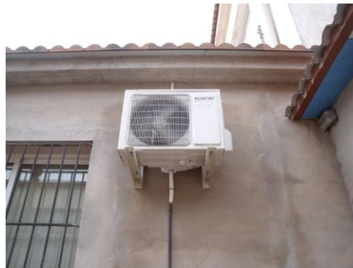
Figura 6. Unitat exterior de climatització
