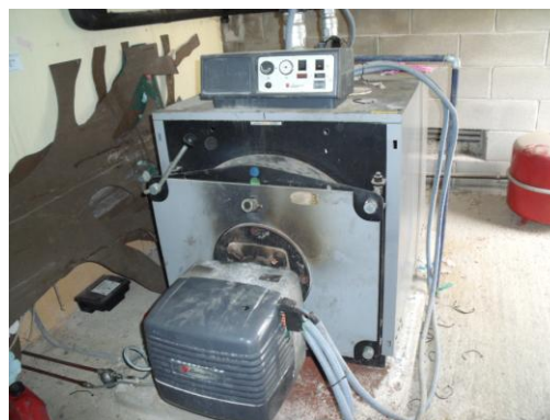
Figura 4. Caldera de calefacció
