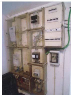
Figura 6. Comptador i quadre elèctric
