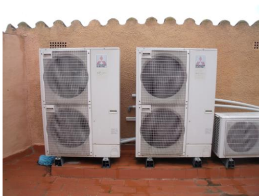
Figura 4. Unitats exteriors de climatització
