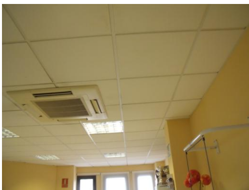
Figura 3. Unitats terminals de climatització
