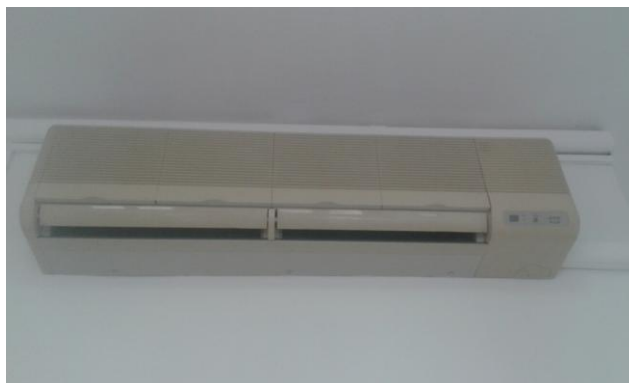
Figura 4. Unitats terminals de climatització tipus split
