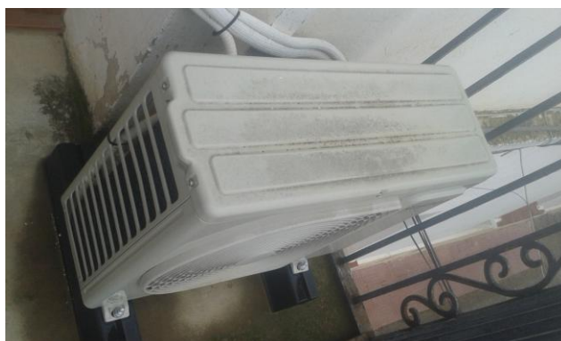
Figura 5. Unitat exterior de climatització
