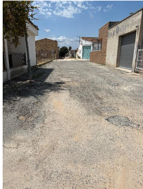
Imatge 10. Estat actual asfalt sector 2. Font: Elaboració pròpia.
