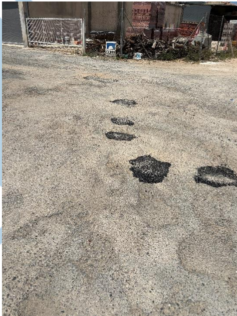
Imatge 11. Estat actual asfalt sector 2. Font: Elaboració pròpia.
