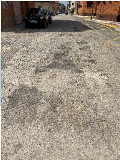
Imatge 5. Estat actual asfalt sector 1. Font: Elaboració pròpia.
