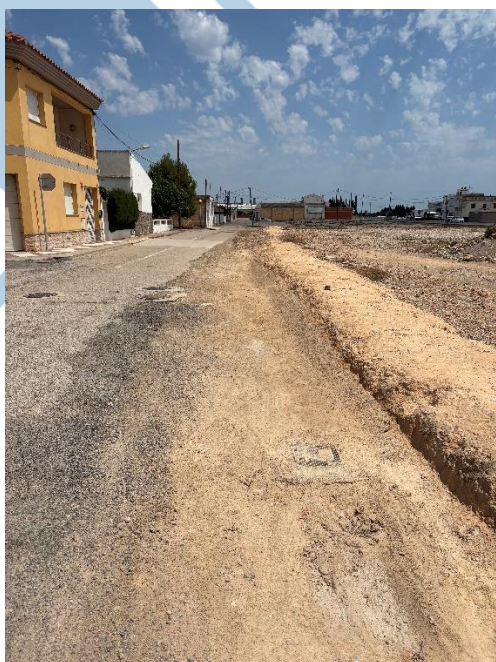
Imatge 3. Estat actual asfalt sector 1. Font: Elaboració pròpia.
