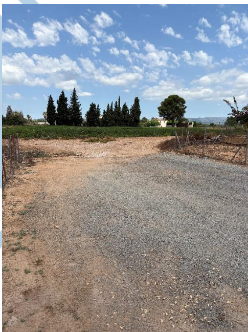
Imatge 7. Estat actual asfalt sector 1. Font: Elaboració pròpia.
