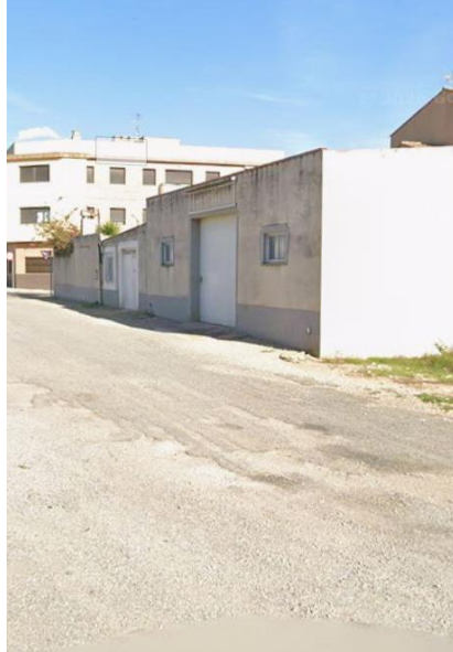
Imatge 14. Estat actual asfalt sector 3. Font: Elaboració pròpia
