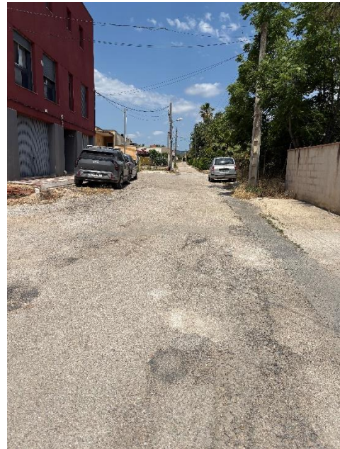
Imatge 12. Estat actual asfalt sector 2. Font: Elaboració pròpia.
