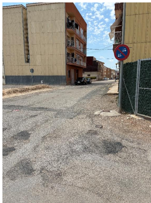
Imatge 2. Estat actual asfalt sector 1. Font: Elaboració pròpia.
