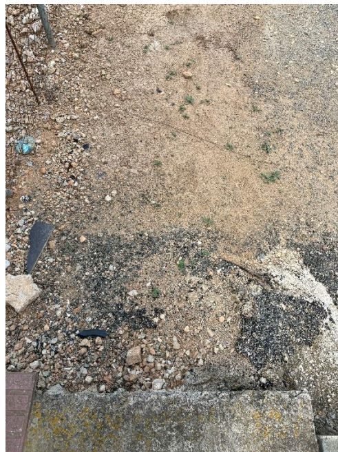
Imatge 6. Estat actual asfalt sector 1. Font: Elaboració pròpia.
