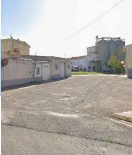
Imatge 13. Estat actual asfalt sector 3. Font: Elaboració pròpia.
