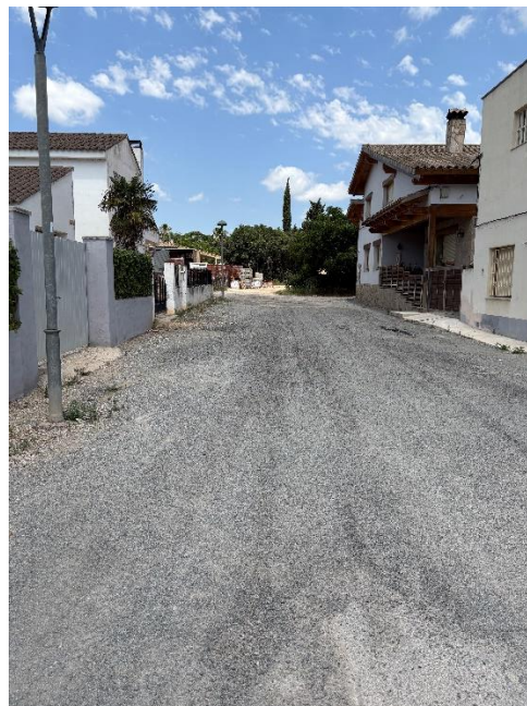
Imatge 8. Estat actual asfalt sector 2. Font: Elaboració pròpia.
