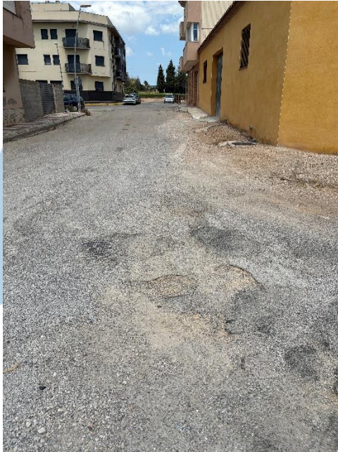
Imatge 9. Estat actual asfalt sector 2. Font: Elaboració pròpia.
