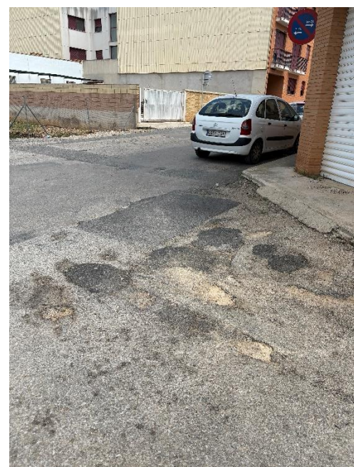
Imatge 4. Estat actual asfalt sector 1. Font: Elaboració pròpia.
