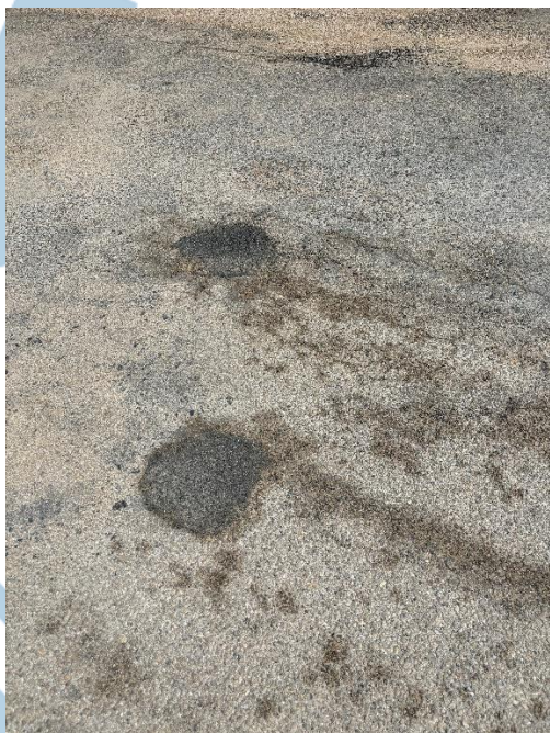
Imatge 1. Estat actual asfalt sector 1. Font: Elaboració pròpia.
