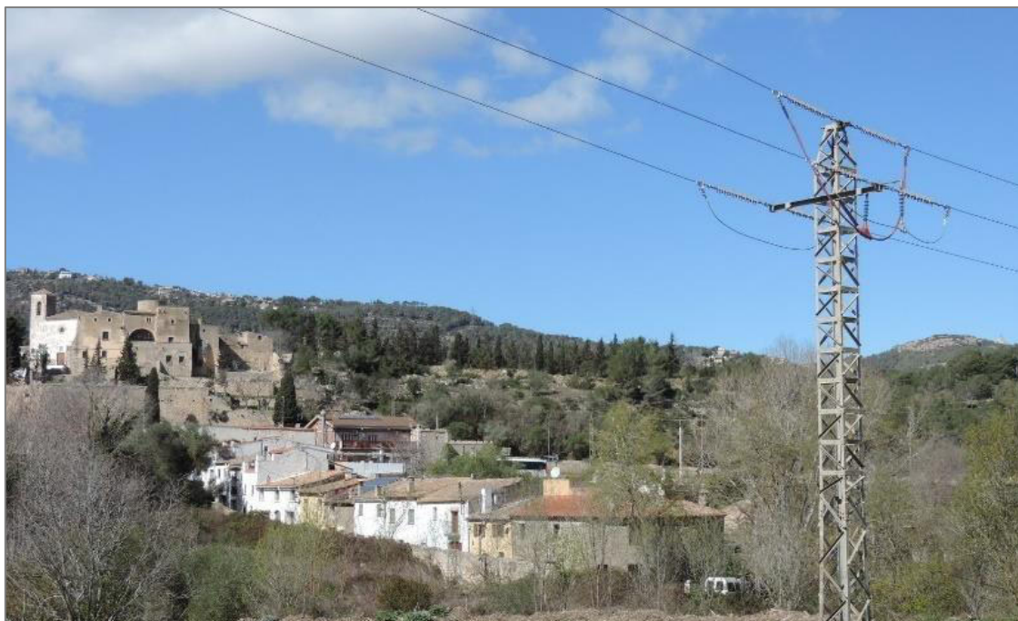
Fotografia 24. Línia elèctrica aèria que travessa l'àmbit del PAU-1 de la MP en sentit N-S, amb tres suports.
