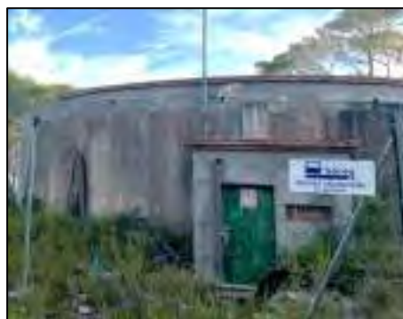
Imatge 16. Dipòsit Alt Vora Sitges
