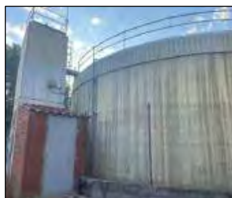
Imatge 7. Dipòsit General ATLL
