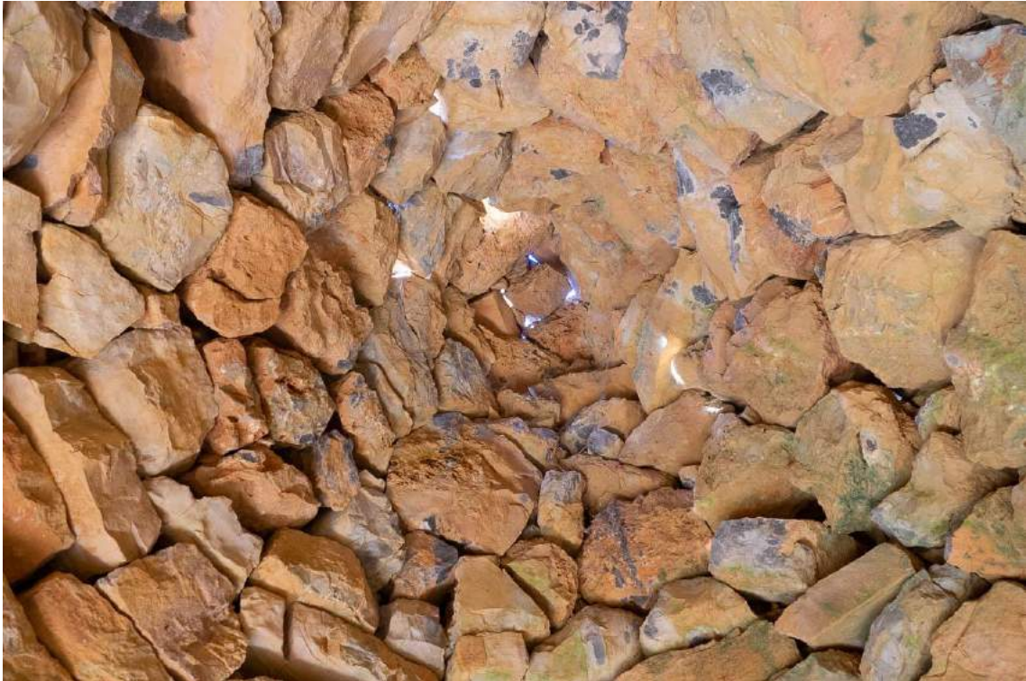
Fotografia 83: La gran majoria de les cabanes de pedra seca segueixen un mateix model constructiu, amb materials molt bastos i poc treballats, raó per la qual requereixen d'un cert manteniment per evitar el seu enrunament. 17/11/2020.
